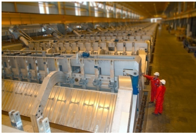
Figur 7: Elektrolysehall ved Hydros verk i Sunndal 35
