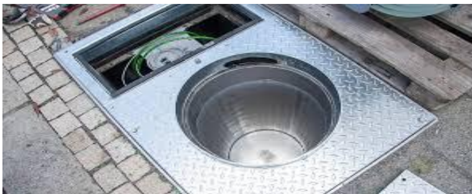
Figur 15: Nedkastpunkt med ventilsjakt (Valle, 2015)
